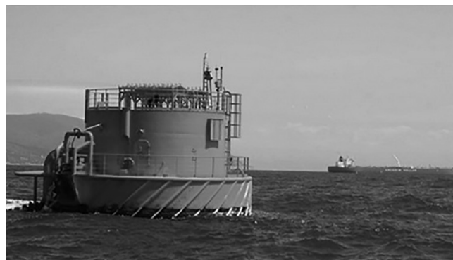
Рис. 4. Причальное устройство КТК для перекачки нефти. Fig. 4. Caspian Pipeline Consortium mooring facility for oil transfer.
